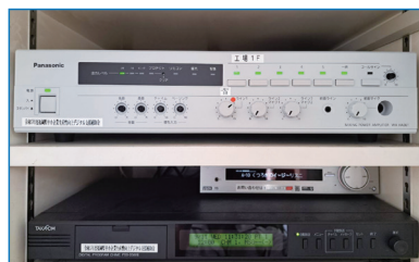
デジタル化した社内放送設備
