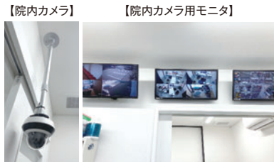
院内カメラによる各室の状況確認
